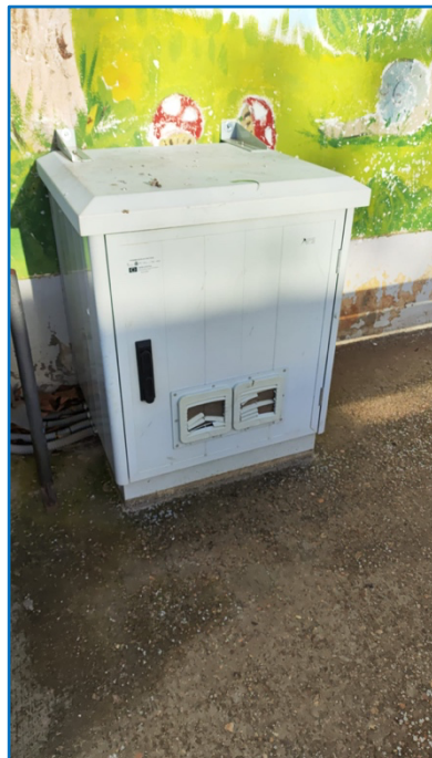
Armario comunicaciones exterior en la escuela de Gordaliza del Pino
