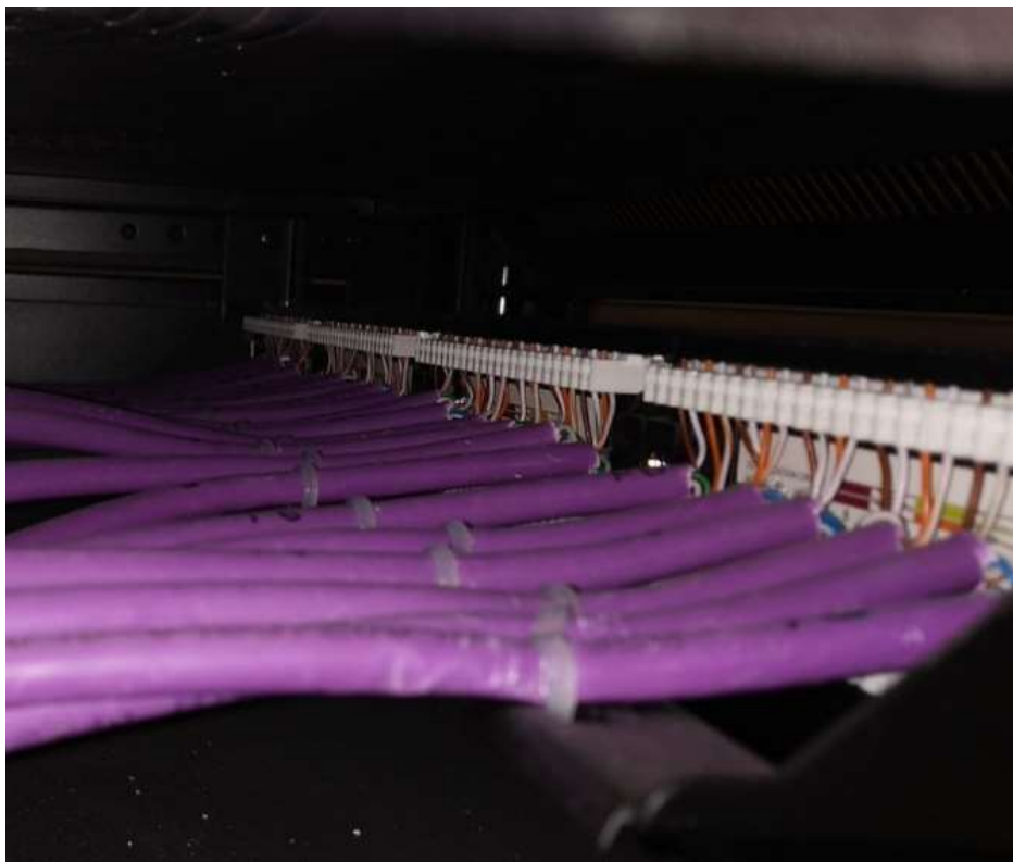
Cableado panel distribución Rack planta primera.
