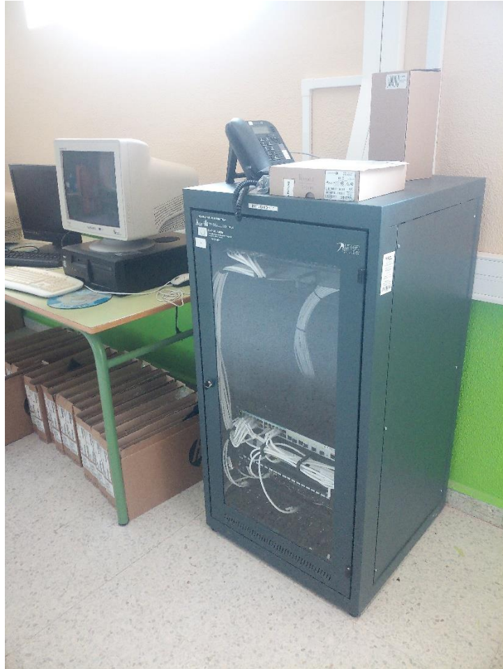
Ilustración 84: Armario EECC en el aula de informática.
