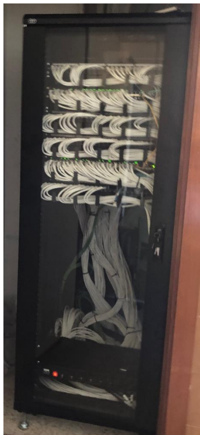
Ilustración 1: Armario de conexiones
