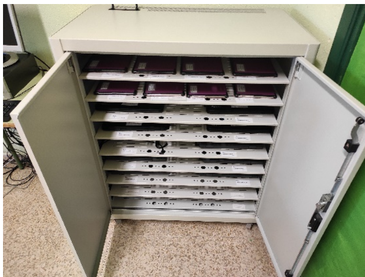
- Interior del armario -
