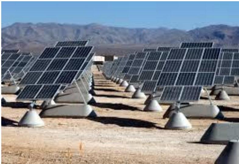
Imagen 12: Placas de energía solar fotovoltaica. Fuente: wikipedia
