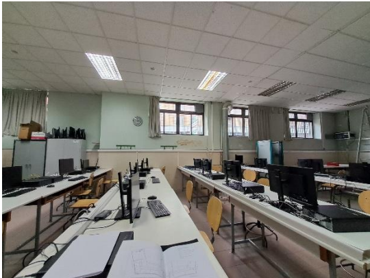
Estado actual humedades en aulas
