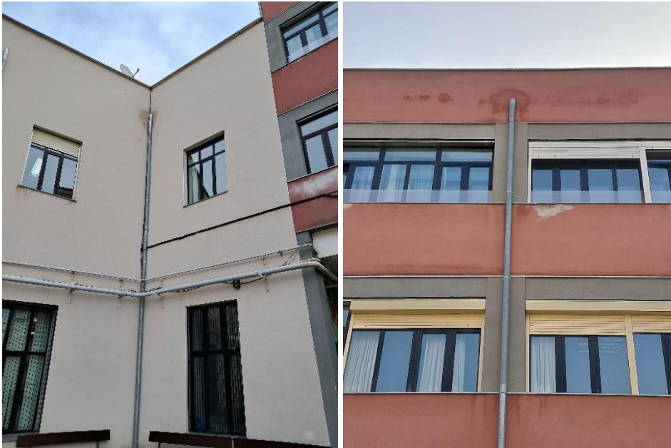
Encuentro bajante canalón en mal estado
