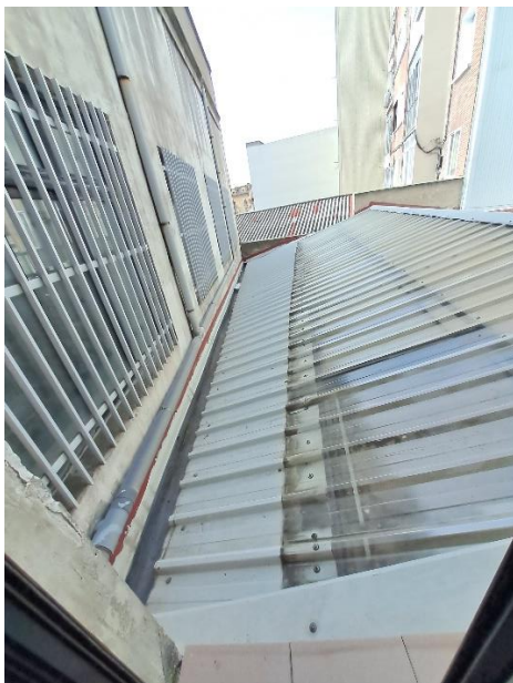
Cubierta con necesidad de mayor evacuación
