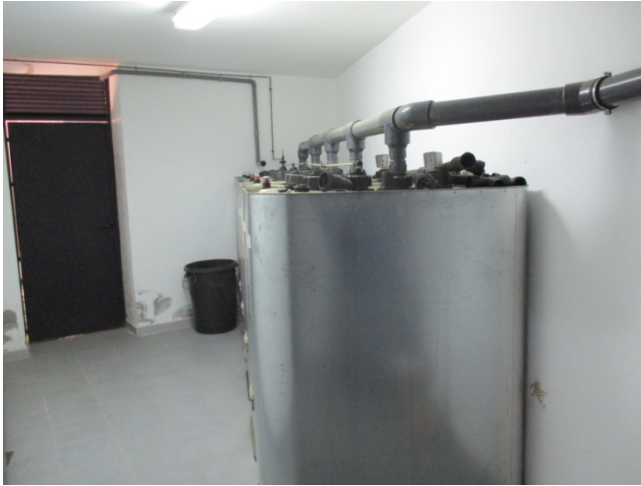
Situación de depósito combustible (1)
