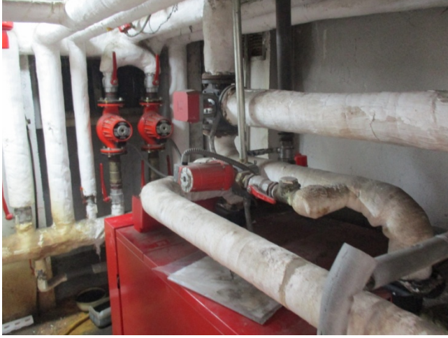
Foto Vista General sala de calderas
