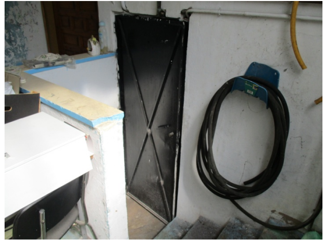
Foto puerta de acceso a sala de calderas.
