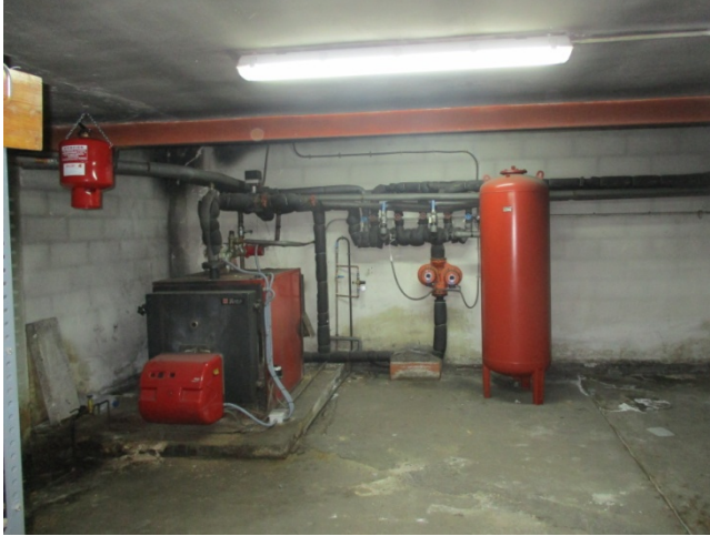
Foto Vista General sala de calderas
