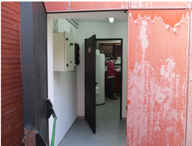
Foto puerta de acceso a sala de calderas.
