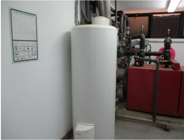
Foto Vista General sala de calderas
