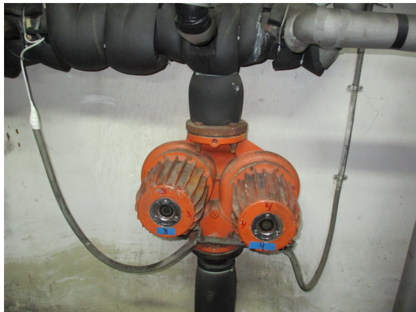
Bomba gemela existente sala 2.
